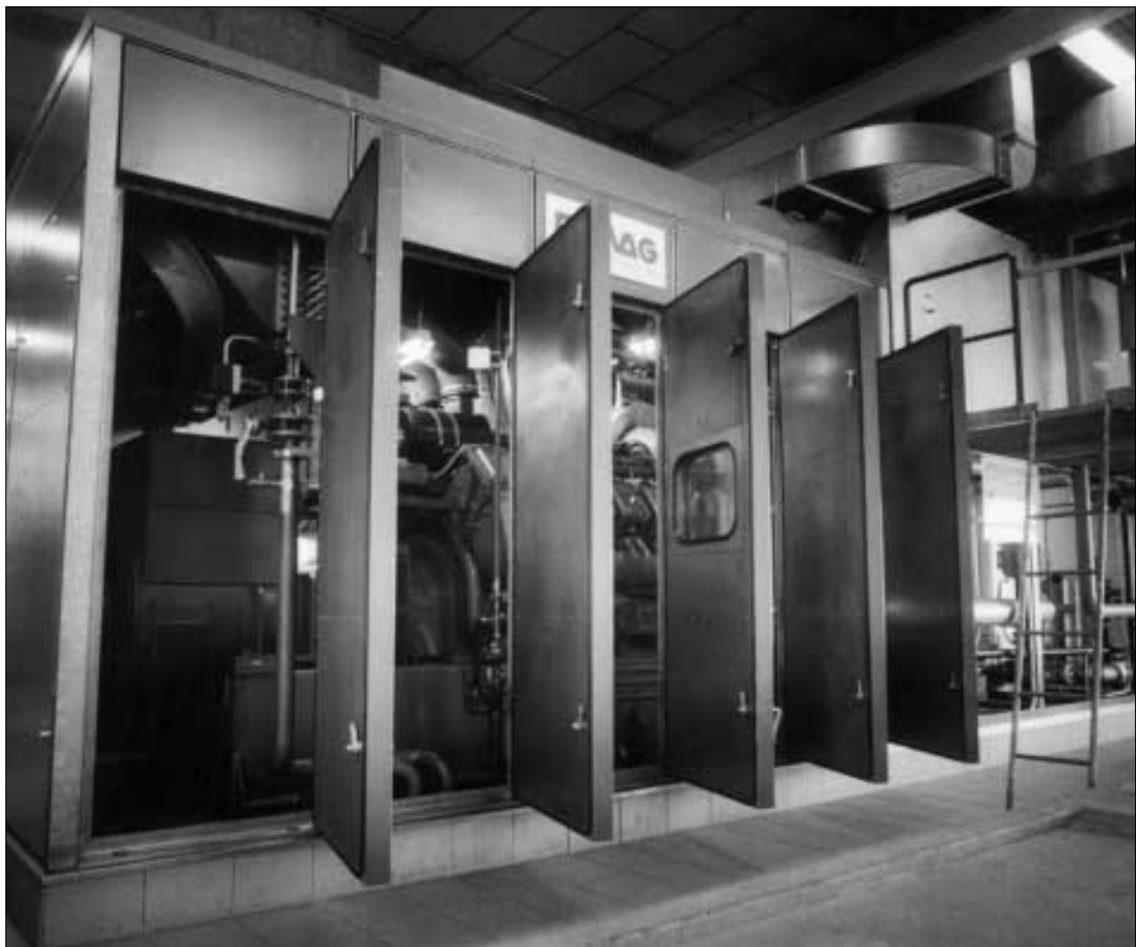
ZURÜCKHALTUNG. Trotz Eigenstrom-Erzeugung und Kraftwerksanteilen hält sich der Kanton Baselland aus der Elektrizitätsmarktdiskussion heraus. Im Bild: Blockheizkraftwerk des kantonalen Fernheizkraftwerks Liestal (Amt für Industrielle Betriebe). FOTO DÜRRENBERGER
