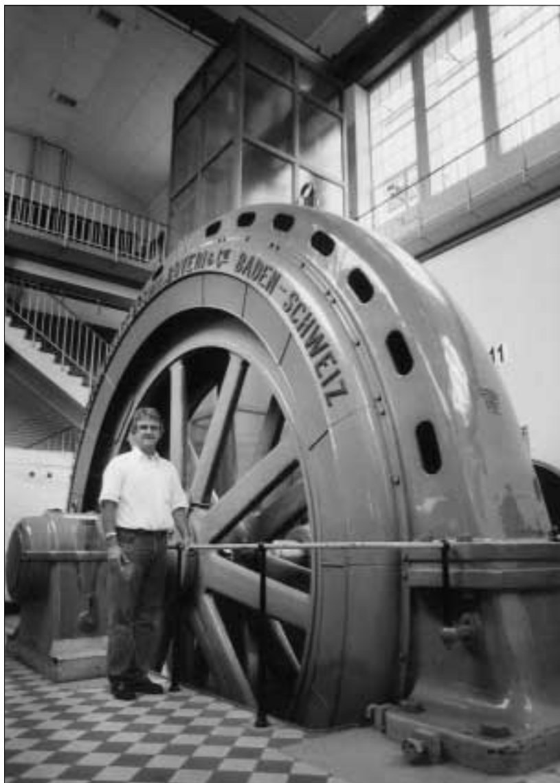
EIGENER STROM. Teils altherwürdige, aber renovierte Generatoren im Rheinkraftwerk Augst (KWA) generieren Elektrizität fürs Baselbieter Netz – das zur Hauptsache aus Gösigen Strom bezieht. Bild: Theo Zeier, Technischer Geschäftsleiter der KWA, vor einem historischen Generator mit Jahrgang 1916. FOTO DÜRRENBARGER
